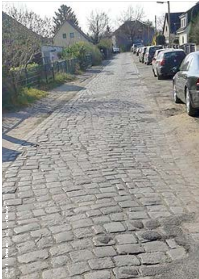
Durchgehende Grunderneuerung notwendig
